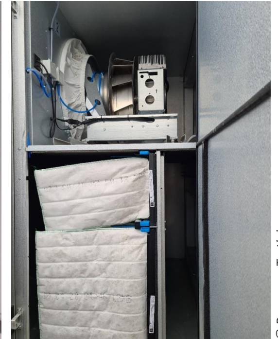
Intérieur de la CTA : filtres, ventilateur...
